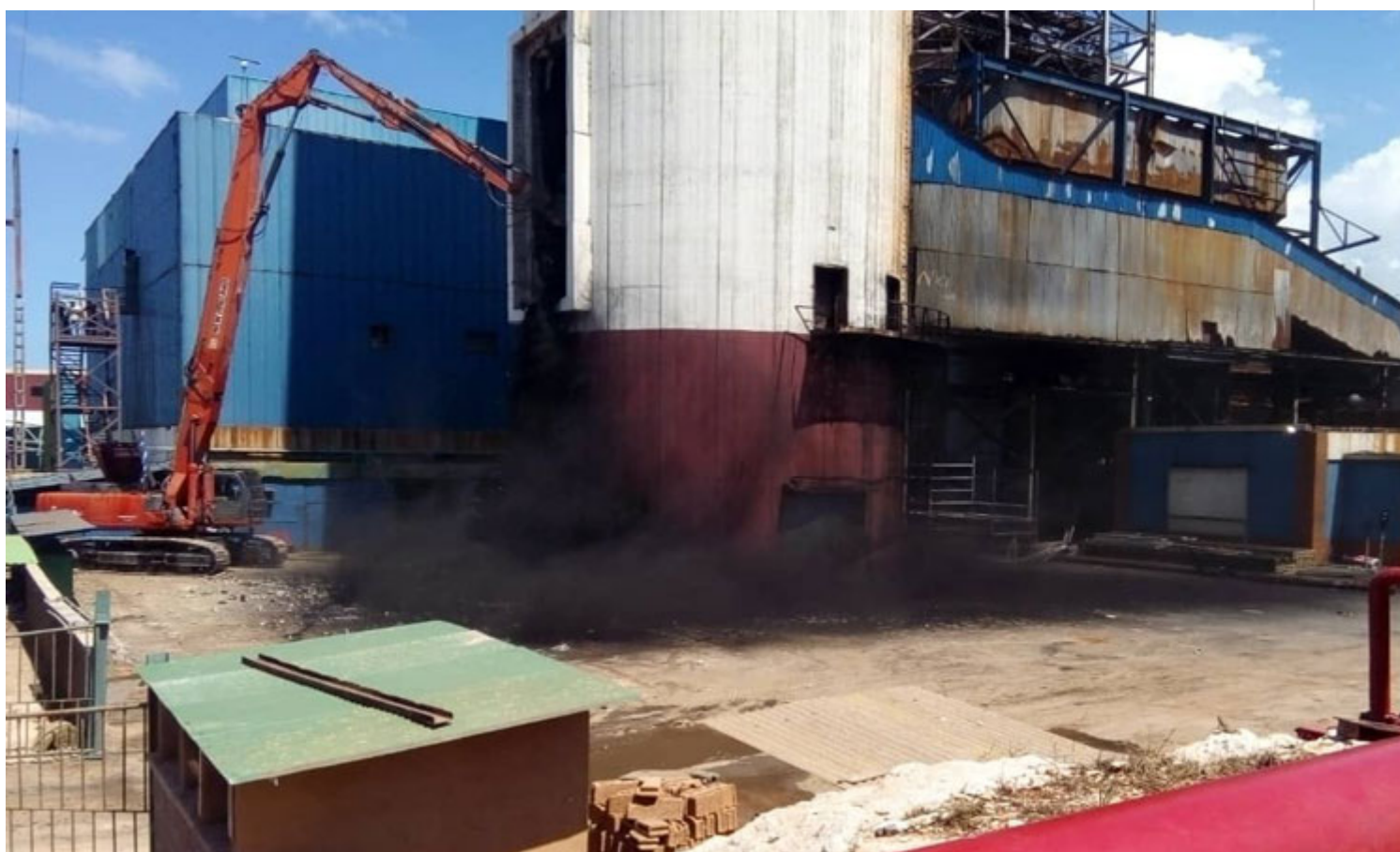
Abierto orificio en chimenea
