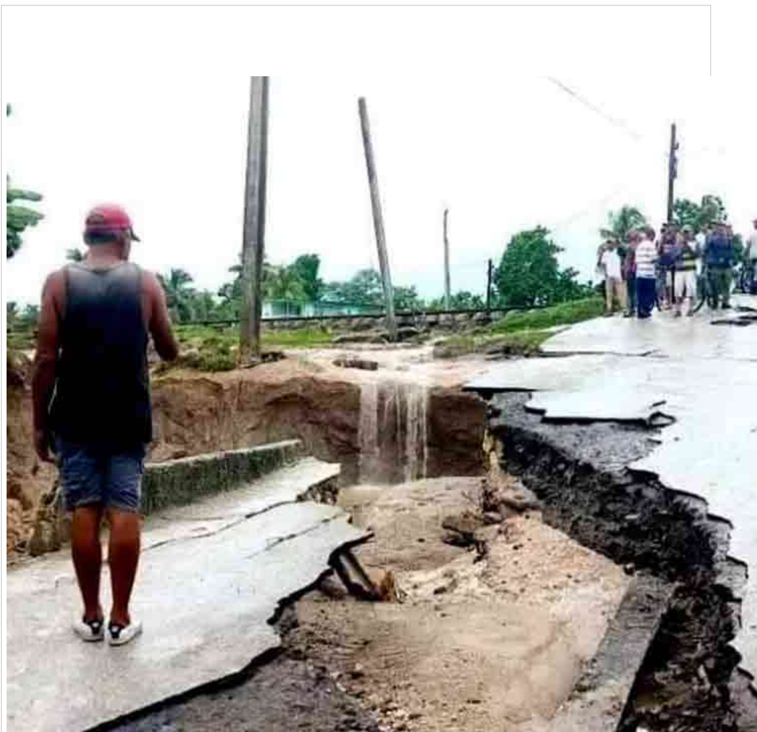
Les routes ont également été gravement endommagées par les pluies. Photo Prensa Latina
