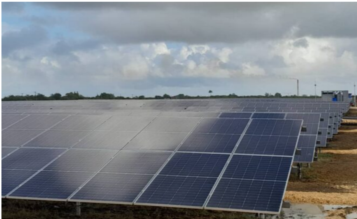
Inauguran en Holguín parque solar fotovoltaico “Corúa 5”.Foto: Trabajadores
